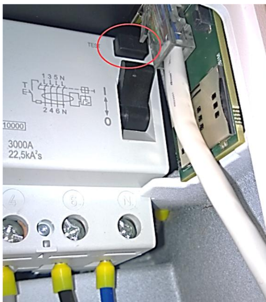
Figura 42: pulsante del test RCD
