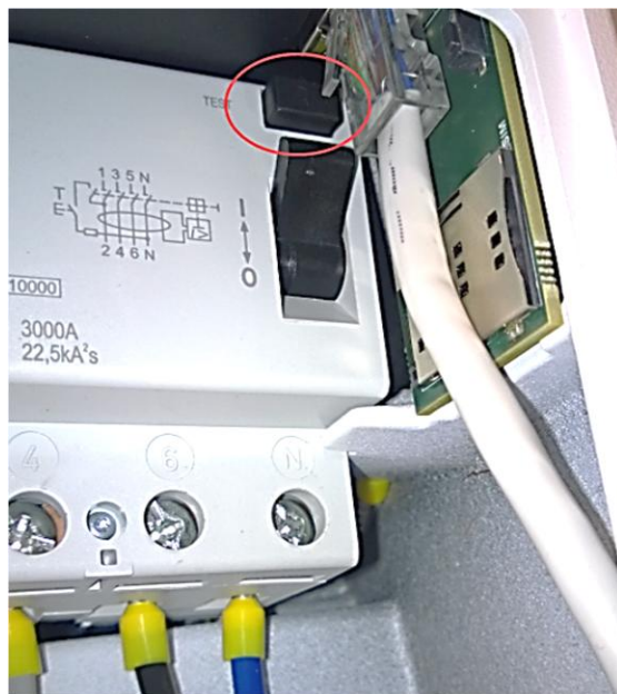
Abbildung 42: Prüftaste des Fehlerstromschutzschalters (RCD)
