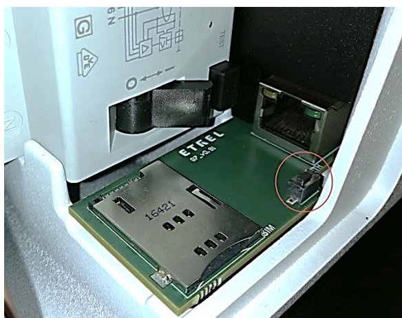
Figure 42: Bouton de réinitialisation à l'intérieur de la zone de maintenance
