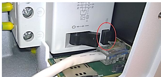
Slika 34: Dugme za testiranje FID prekidača (RCD)
