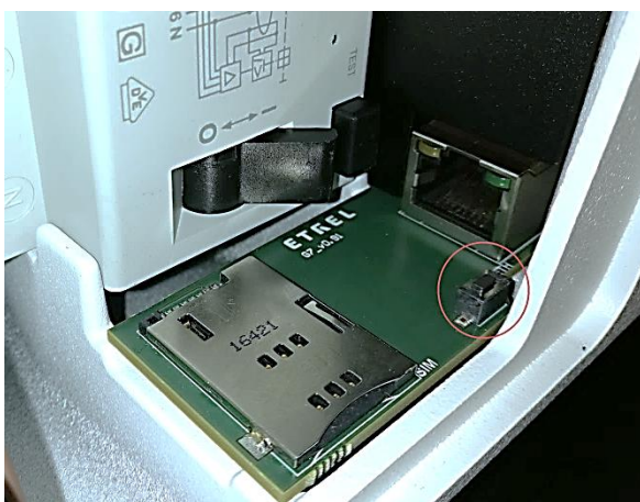
Slika 42: Gumb za ponovni zagon znotraj vzdrževalnega prostora
