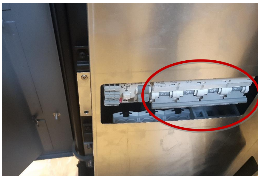
Afbeelding 45: De hoofdstroomonderbreker kan worden gebruikt om het laadstation te resetten
