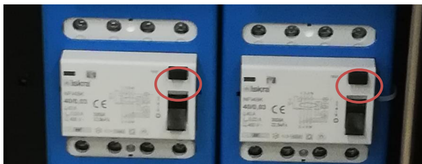
Slika 44: Gumbi za testiranje RCD sklopke
